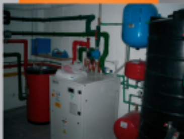
Γεωθερμικό ψυχοστάσιο Αρχάνες
