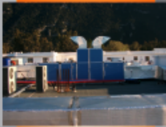
Κεντρική κλιματιστική μονάδα
