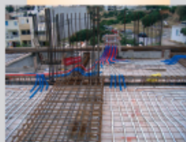
Θέρμανση - Ψύξη Πυρήνα Σκυροδέματος Αγ. Νικολάος
