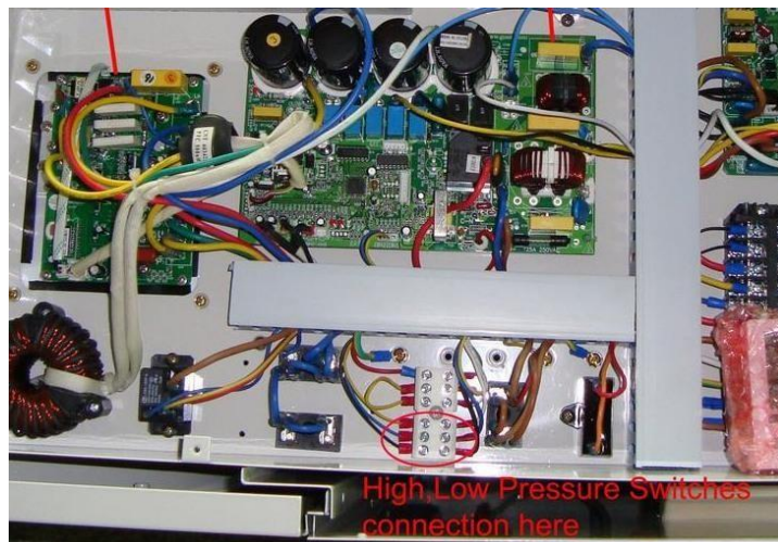
Θύρα σύνδεσης Διακόπτη Υψηλή Χαμηλής Πίεσης
